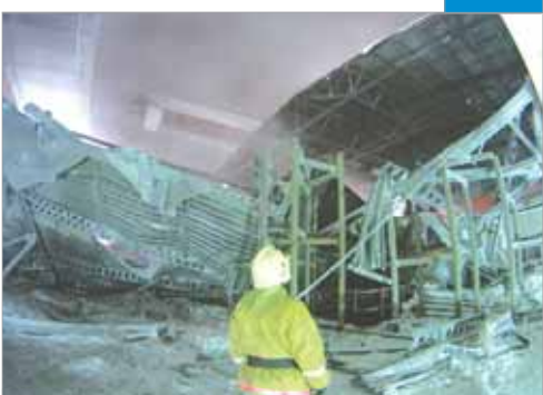
На ГРЭС-2 устраняют последствия
